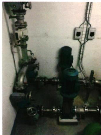
Bild: Pumpen neu
