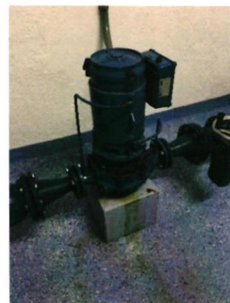
Bild: Pumpen alt
