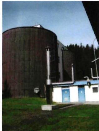
Bild: neue Gasfackel an neuem Standort
