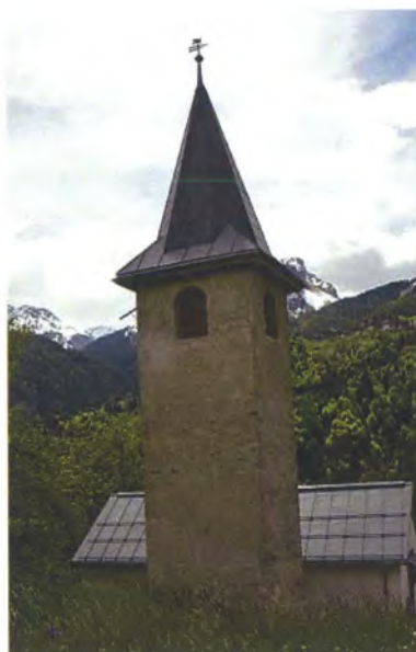
Der Turm der Dorfkirche von Lüen muss saniert werden.
