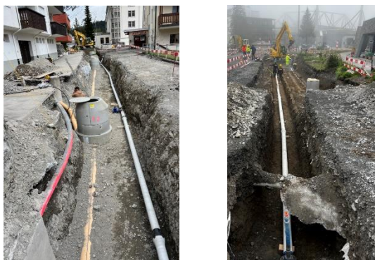
Wasserleitungen: Alteinstrasse (links), Poststrasse (rechts)
