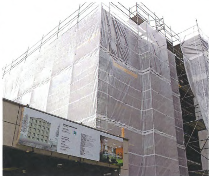
Der Schulhausneubau in Arosa geht zügig voran. 2019 stehen dafür 3,69 Mio. Franken im Budget.
